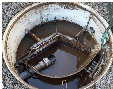
Dysfonctionnement - Présence de boue dans le rejet
