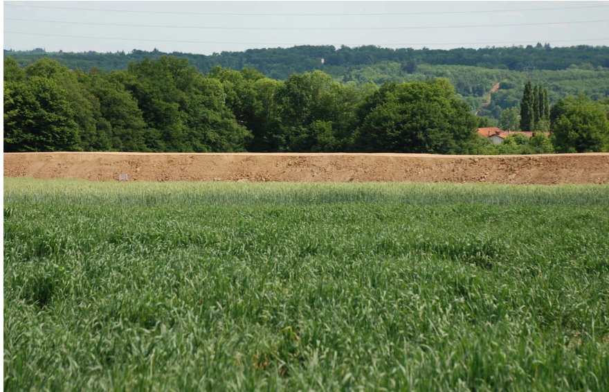
Travaux de la déviation de Chabanais, entre Etagnac et Beaulieu; les nouvelles voies surélevées donnent l'opportunité de la découverte des paysages de vallée, tout en l'impactant depuis la rive opposée
